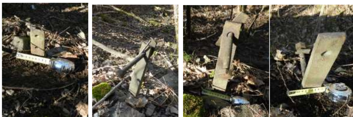
Figur UM9: Braketter med bolter som festet overstrukturen til støttemuren
