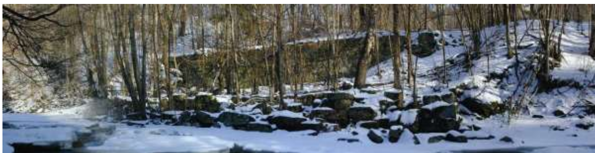
Figur UM8: Mølla sett fra Bærumsiden: Merk den 30. meter lange støttemuren lengst vekk fra Lysakerelva. Muren har begynt å sige fremover øverst mot nord (til venstre i bildet).
