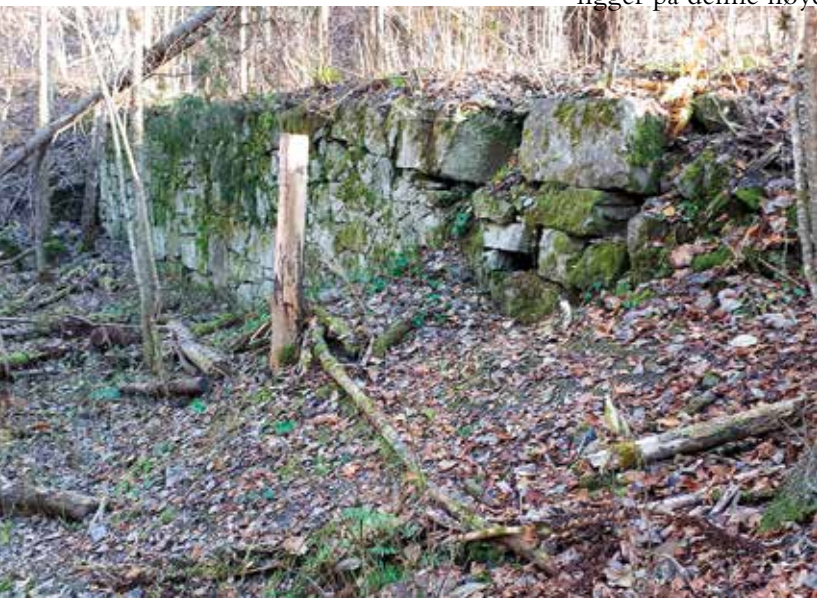
Ullern mølles underetasje. Støttemuren er 30 meter lang og 3,5 meter høy. Den er under betydelig trykk bakfra og trenger ekspertvedlikehold. Foto John Tibballs 2019
